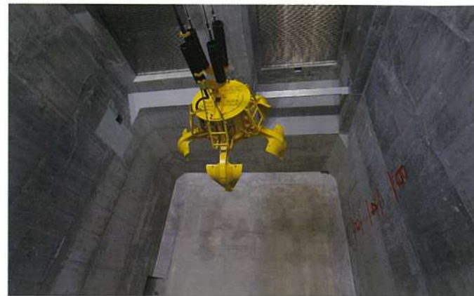
不燃ごみピット 不燃ごみピットに貯められたごみは攪拌した後、ごみクレーンにて不燃性粗大ごみ受入ホッパへ投入します。ごみピットは約3日分（約390m³）のごみをためることができます。
