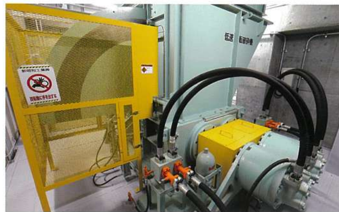
低速回転破砕機 ゆっくりと回転する刃で可燃性粗大ごみを大まかに破砕し、エネルギー回収推進施設へ搬出します。
