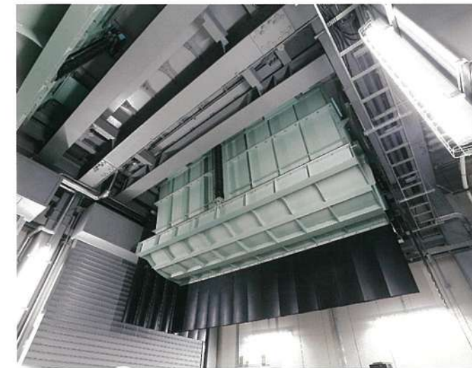
貯留バンカ 回収された鉄類とアルミ類を一時貯留し、場外へ搬出します。
