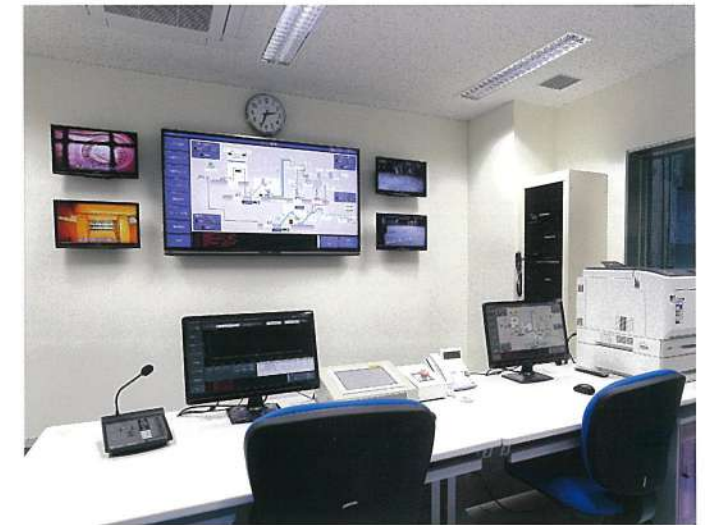
中央操作室 施設全体の処理ラインを管理します。機器の状態や処理の状況をモニタなどで監視し、安全で効率の良い運転を行います。
