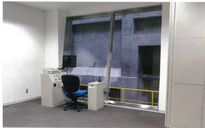
クレーン操作室 ごみクレーンを操作し、不燃ごみピットの中のごみを攪拌してから高速回転破砕機に投入します。
